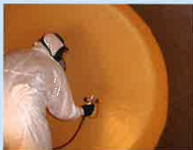
1. SST2-スプレーアップを施工(下地処理はサンドプラストによる第1種ケレン)
